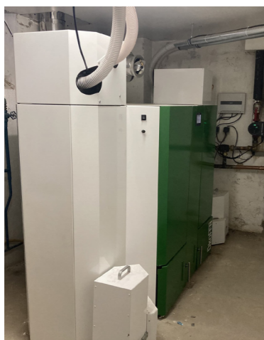
Chaufferie réalisée à Alet-les-Bains
